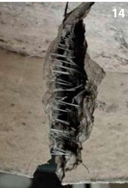
Stahlfaserbewehrter Tübbing nach dem Bruch
