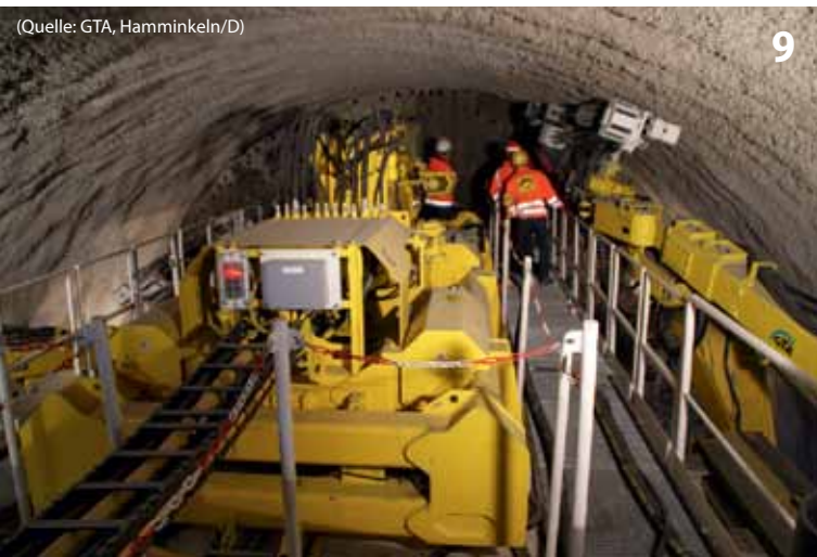
Tunnelerweiterungsportal TEP 8400B für die Tunnel Langenau und Hollerich Tunnel enlargement portal TEP 8400B for the Langenau and Hollerich tunnels
